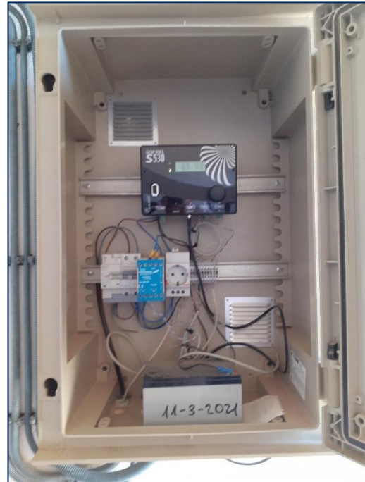
Il·lustració 14. Equip de telecontrol de l'ETAP.
