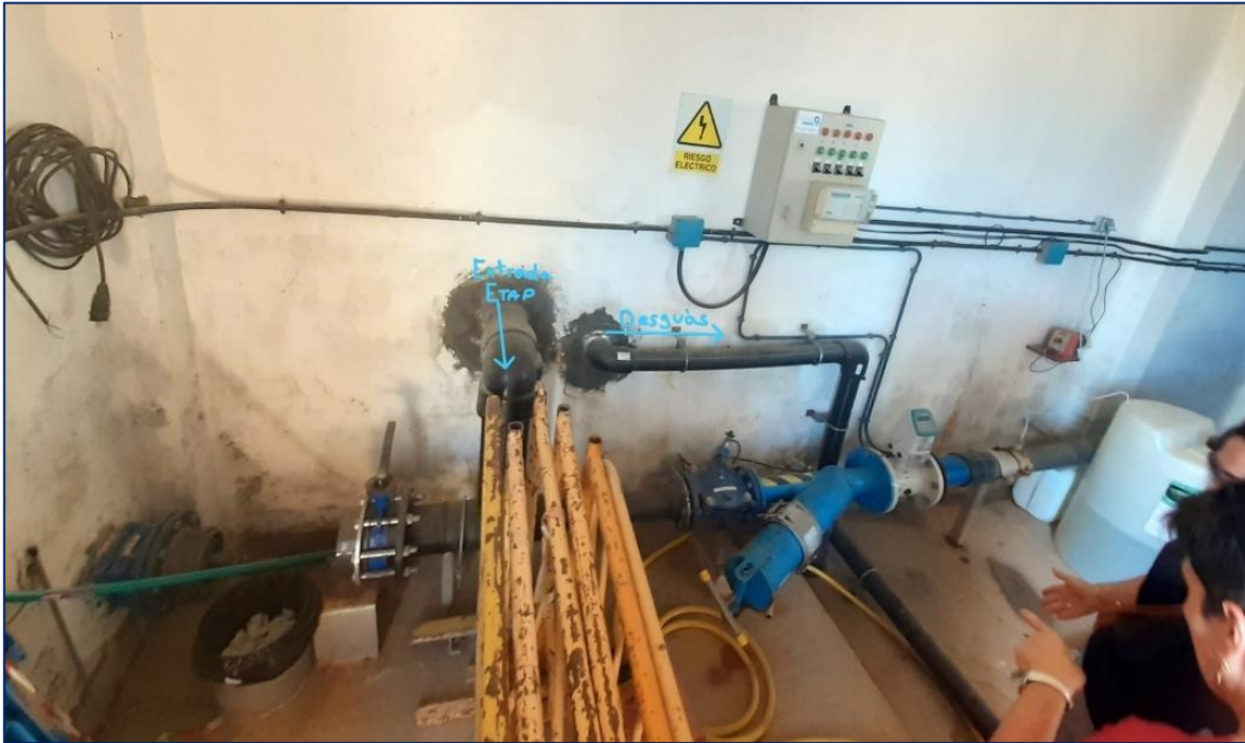
Il·lustració 7. Canonada d'entrada a l'ETAP, i de desguàs.
