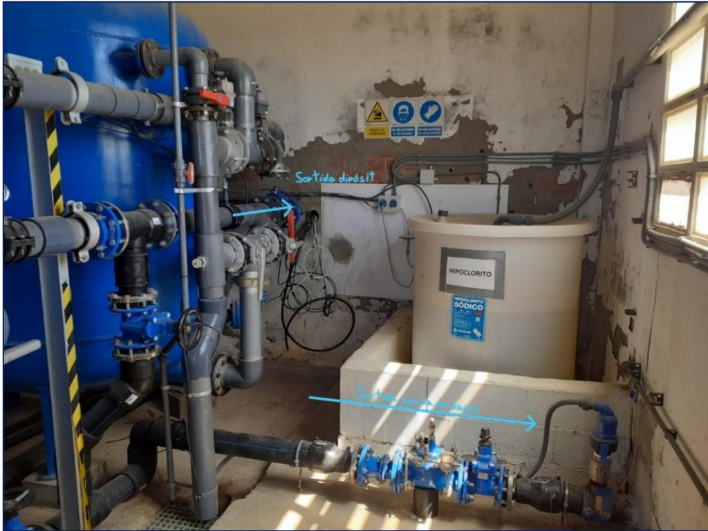
Il·lustració 9. Dipòsit d'hipoclorit sòdic, sortida cap al dipòsit i sortida directa cap a la xarxa en baixa.
