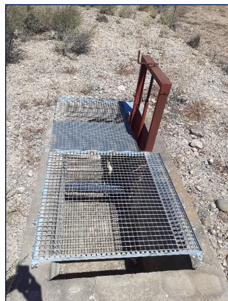
Il·lustració 3. Arqueta d'entrada de l'embassament Municipal per on rep l'aigua del canal Catalunya – Aragó (actualment tancada).
