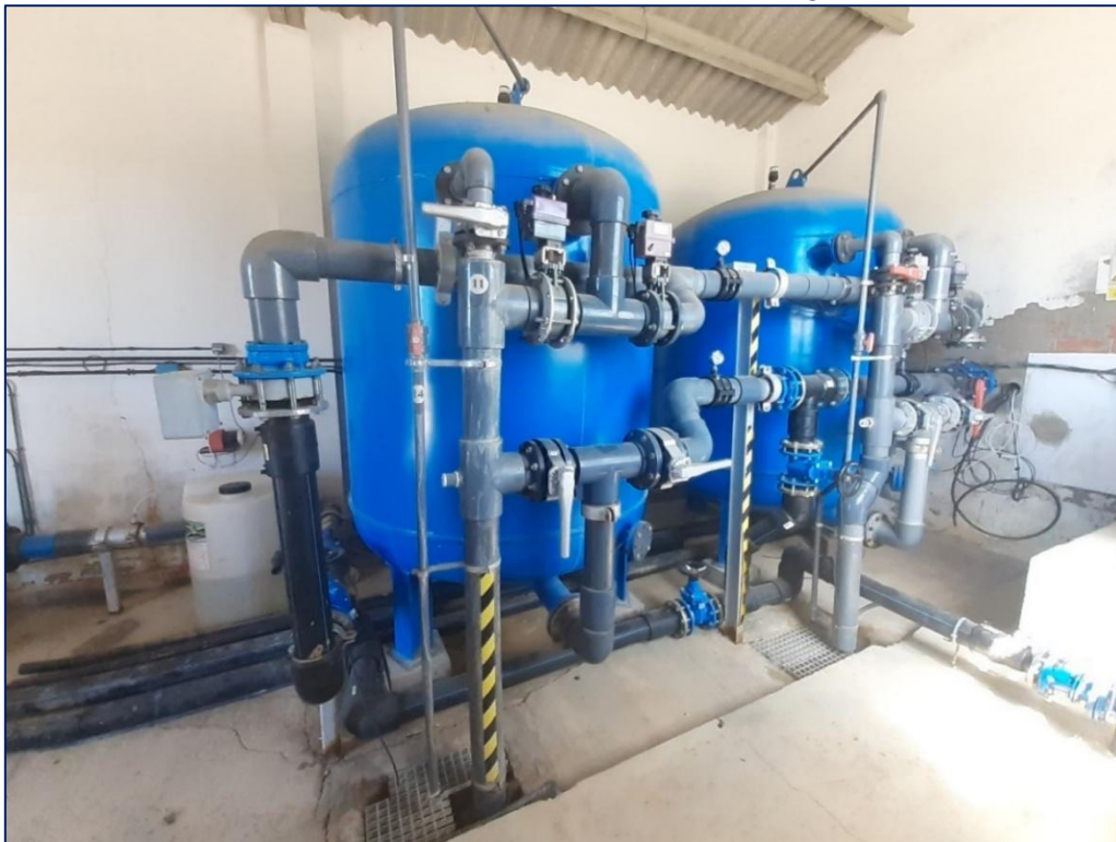
Il·lustració 8. Instal·lacions de tractament de l'interior de l'ETAP.
