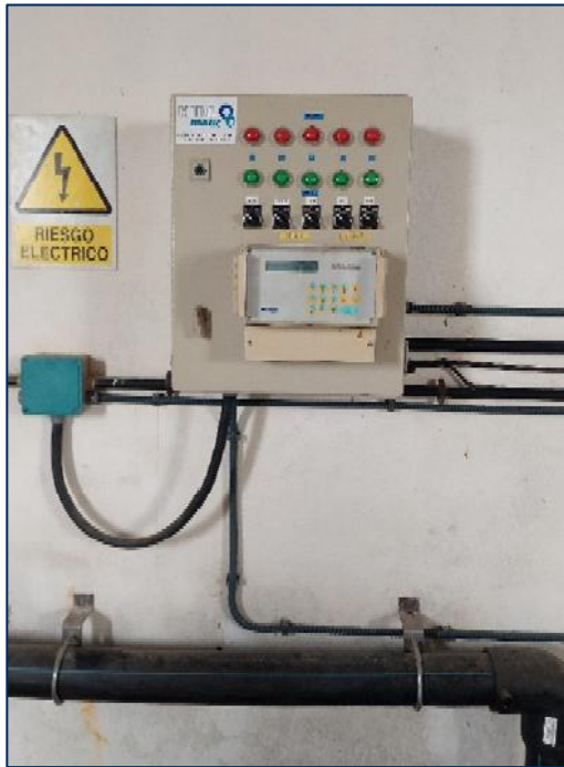
Il·lustració 13. Exterior de la caixa on està instal·lat l'equip de telecontrol de l'ETAP.
